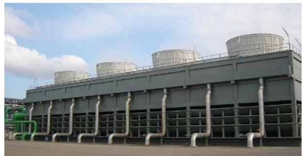
Torres de refrigeración de hormigón
