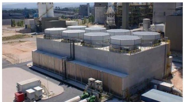
Torres de enfriamiento con disminución de ruido
