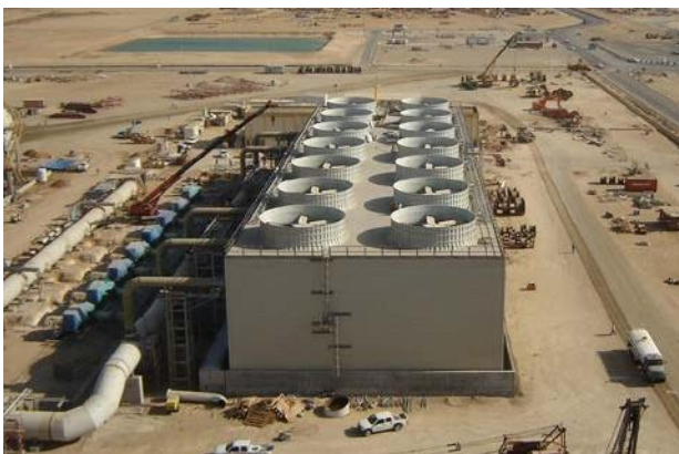
Torres de enfriamiento de FRP en una instalación de refinación y petroquímica en Arabia Saudita
