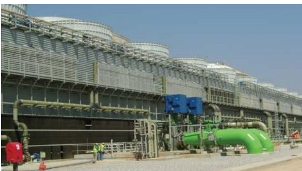
Torre de refrigeración de agua de mar en una planta de ciclo combinado de 2 x 425 MW
