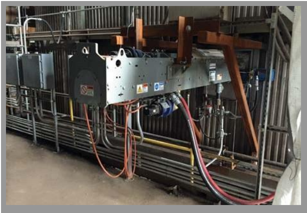
Instalación del sistema HydroJet-R (placa de cubierta superior (retirada para mantenimiento))
